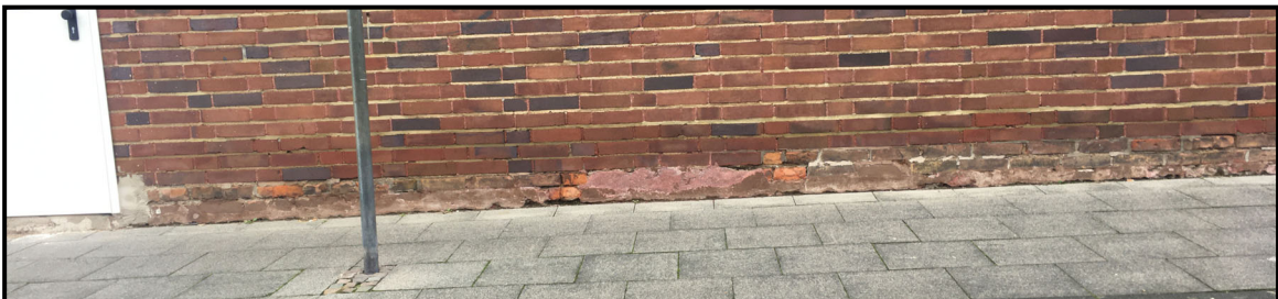
Foto 07 "marode Fugenabdichtung Fassade Herderstraße" 24.01.2022
